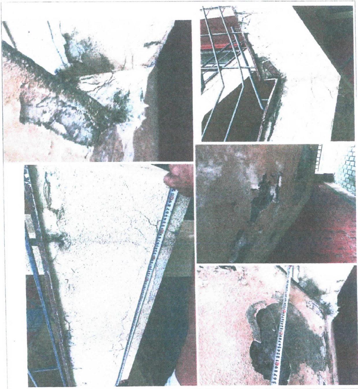
Разрушение отделочного слоя фасада вследствие замачивания
